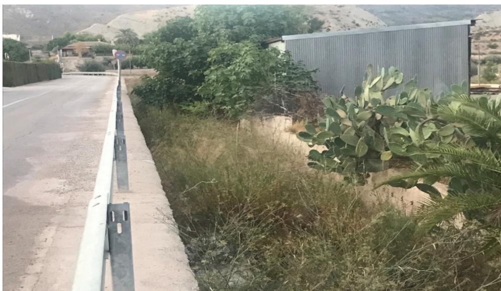
Ilustración 5 RAMBLA DE YLORCI, SEPTIEMBRE 2021.
